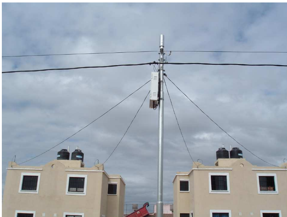
UBICACIÓN DE LAS CAJAS PERPENDICULARES A LA LÍNEA DE DISTRIBUCIÓN ACOMETIDAS DE VIVIENDAS TIPO DUPLEX. RETENCIÓN REALIZADA SOBRE LA PARED LAS FOTOGRAFÍAS SON SÒLAMENTE INDICATIVAS
