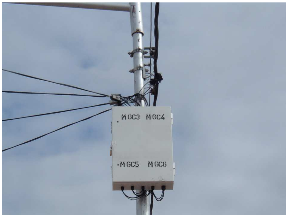
UBICACIÓN DE LAS CAJAS PERPENDICULARES A LA LÍNEA DE DISTRIBUCIÓN. DETALLE DE TENDIDO DE ACOMETIDAS. LAS FOTOGRAFÍAS SON SÒLAMENTE INDICATIVAS
