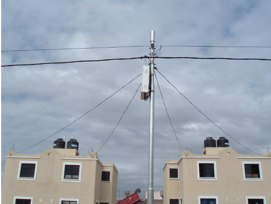
UBICACIÓN DE LAS CAJAS PERPENDICULARES A LA LÍNEA DE DISTRIBUCIÓN ACOMETIDAS DE VIVIENDAS TIPO DUPLEX. RETENCIÓN REALIZADA SOBRE LA PARED LAS FOTOGRAFÍAS SON SÒLAMENTE INDICATIVAS
